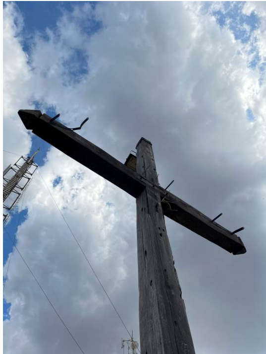
Foto 05: Suportes metálicos para iluminação restantes no Cruzeiro, após retirada das luminárias.
