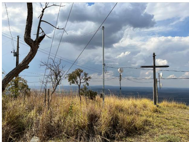
Foto 01: Entorno do Cruzeiro com diversas fiações, postes e antenas.
