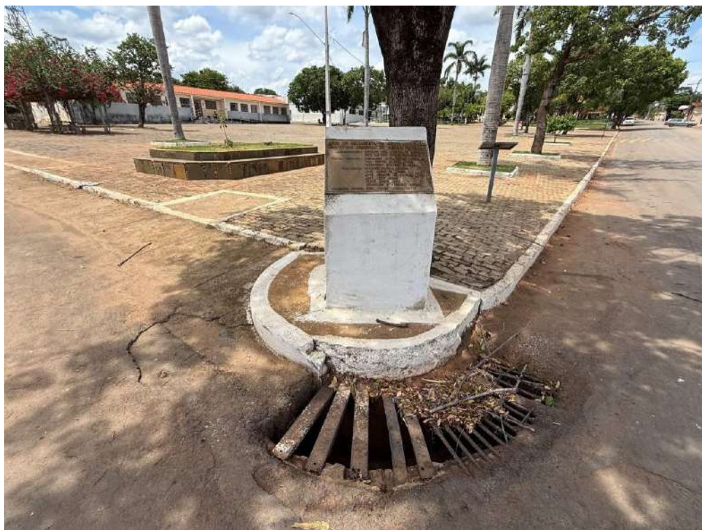
Foto 06 (04/11/2025) Detalhe da grelha apresentando danos superficiais e acúmulo de sujidades. Autoria: Racchel Santiago
