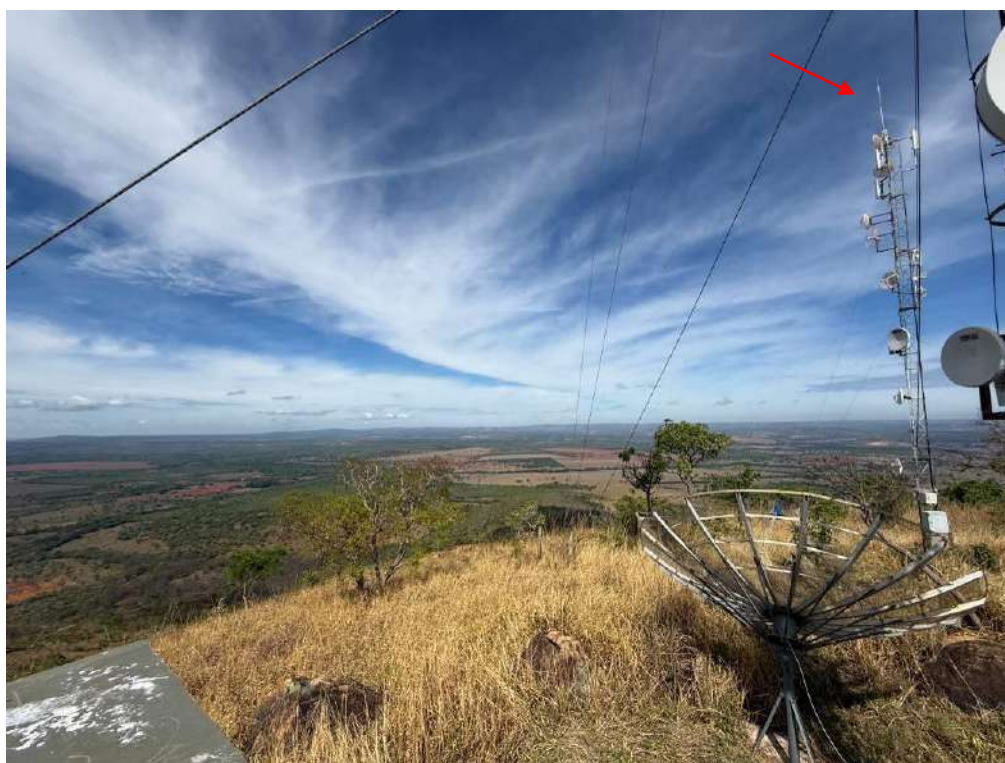
Foto 22 (04/11/2025) Detalhe de para-raios instalado em uma das antenas. Autoria: Racchel Santiago
