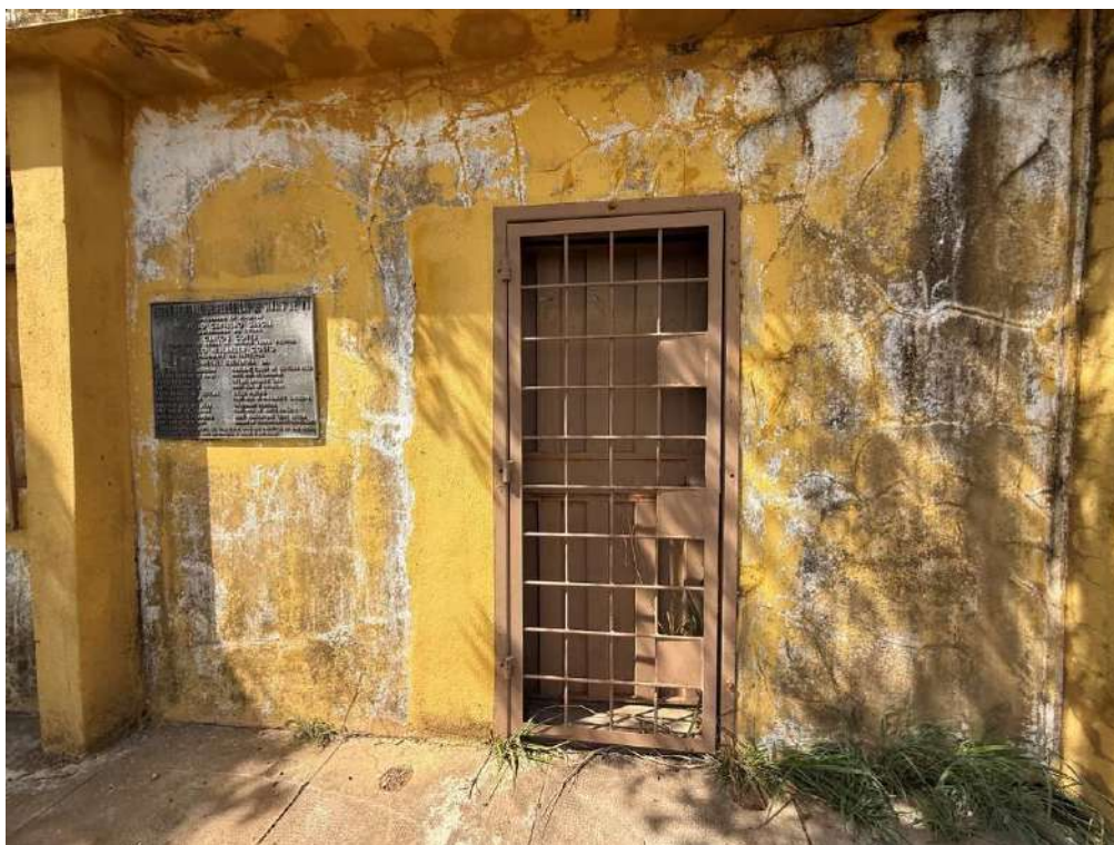
Foto 12 (04/11/2025) Trecho da fachada frontal da edificação apresentando danos superficiais. Autoria: Racchel Santiago
