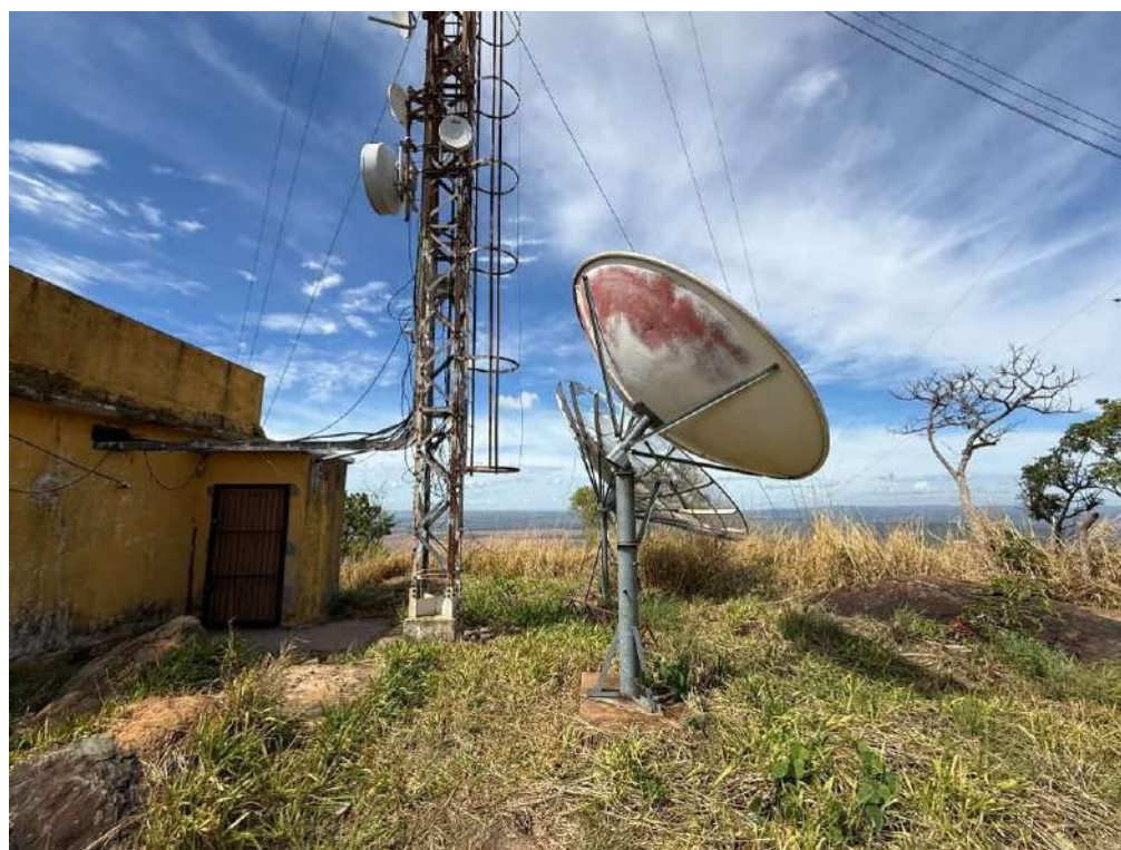
Foto 17 (04/11/2025) Antenas localizadas na lateral da edificação técnica. Autoria: Racchel Santiago
