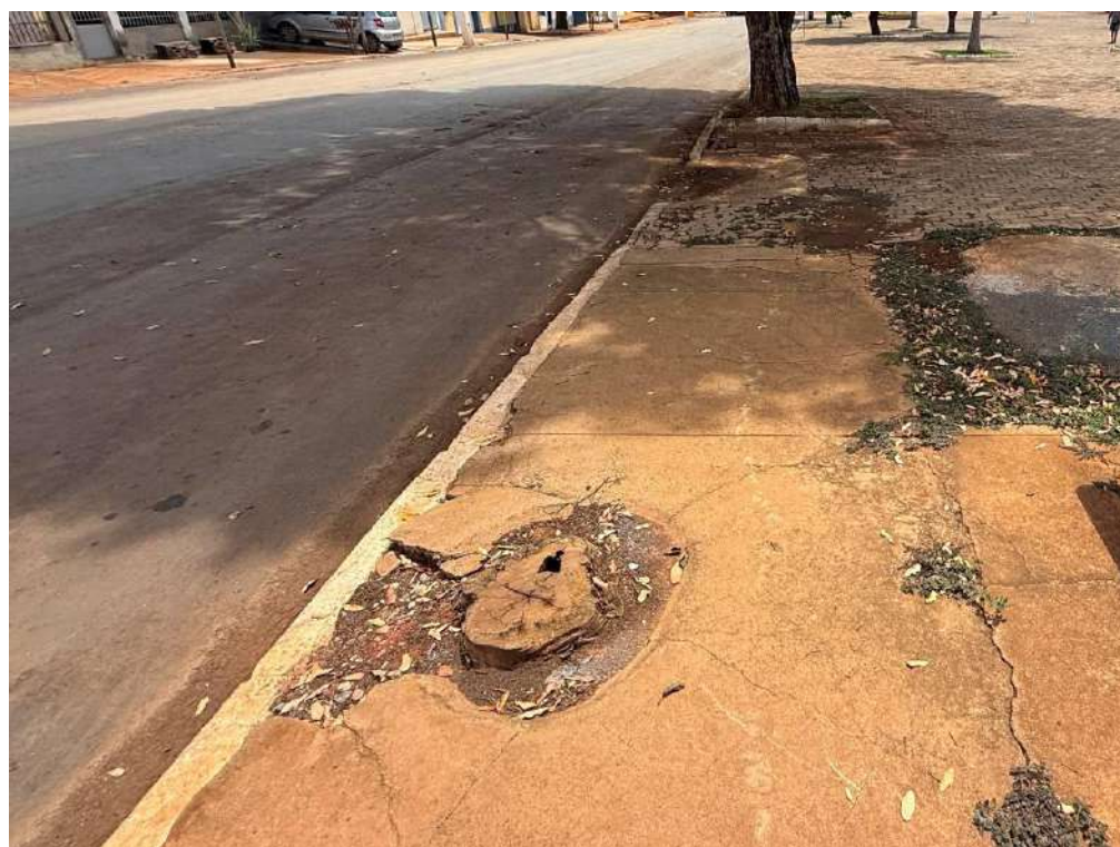
Foto 07 (04/11/2025) Trecho onde se observa acúmulo de sujidades na sarjeta. Autoria: Racchel Santiago
