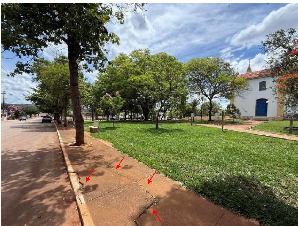
Foto 11 (04/11/2025) Trecho do passeio apresentando danos superficiais. Autoria: Racchel Santiago
