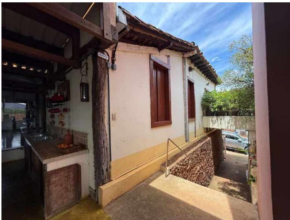
Foto 03 (04/11/2025) Trecho da estrutura em madeira apresentando danos superficiais. Autoria: Racchel Santiago
